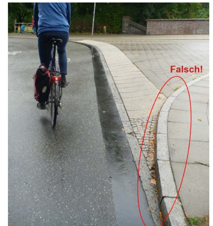
Abbildung 23: Falsche Ausbildung einer Gehwegüberfahrt, ebenfalls Hamburg. Der Bordstein folgt der einmündenden Straße (Uferstraße/Von-Essen-Straße).
